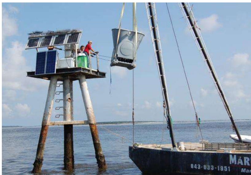
Figura 19 – Detalhe de instalação de um SODAR em plataforma no Oceano Atlântico, próximo a Georgetown (MARINET, 2014).
